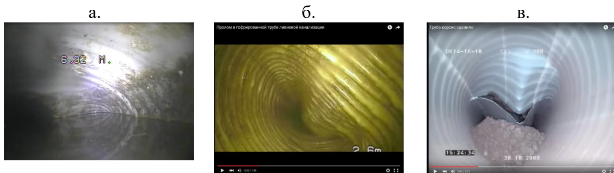
Рис. 1. Деформация гофрированного полиэтиленового трубопровода. а – канализационного трубопровода диаметром 315мм; б – в ливневой канализации; в – трубы Корсис
