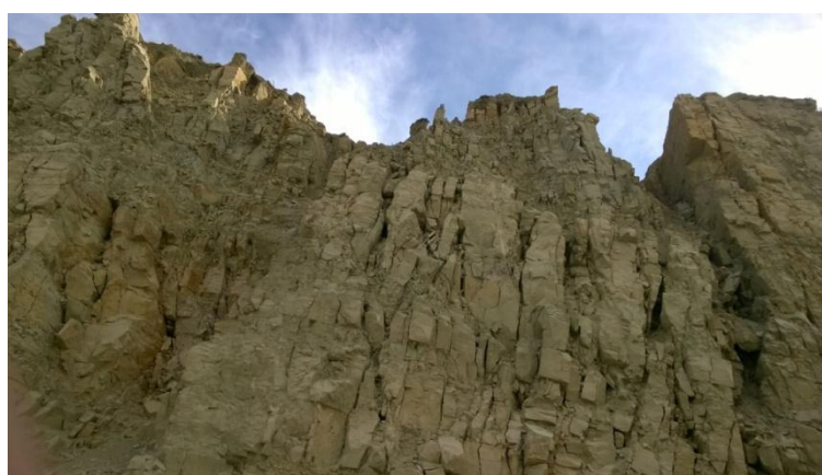
Рис. 1. Обвалоопасный участок бортового откоса карьера «Зарница»
