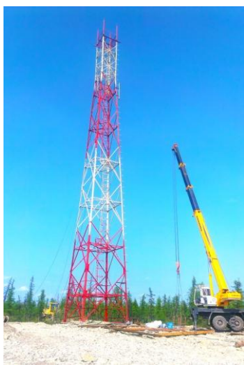
Рис. 1. Антенно-мачтовое сооружение связи
