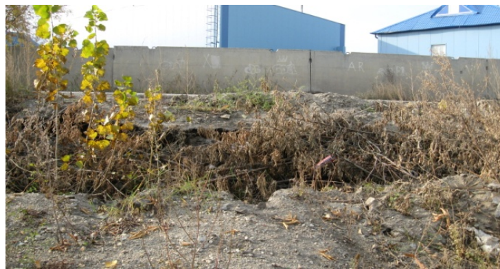
Рисунок 3.8 – Обрушение обочин асфальтированной дороги
