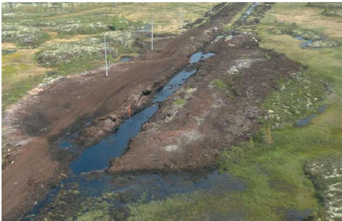
Рисунок 22 – Участок трубопровода в «окружении» бугров пучения [24]
