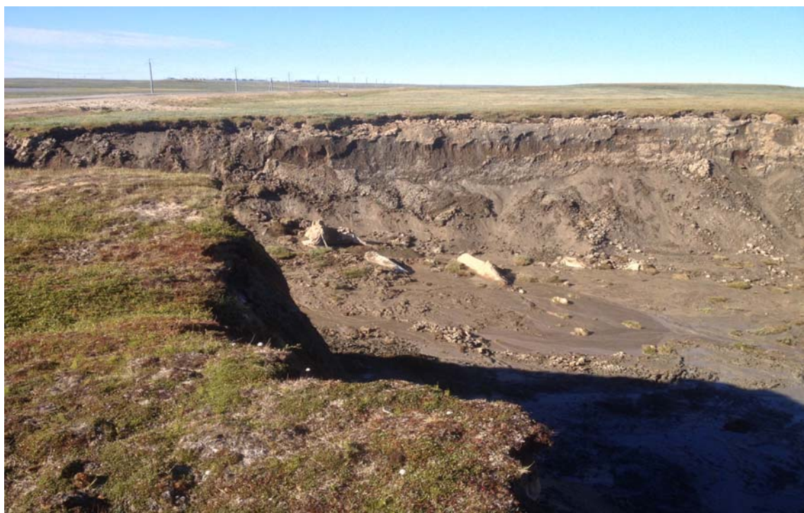
Рисунок 35 – Обвалы почвы в районе строительства автодороги
