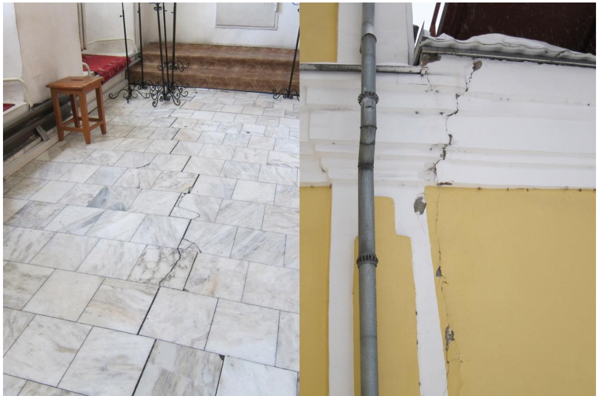
Рисунок 4.10 - Трещины внутри и снаружи Спасо-Преображенского собора
