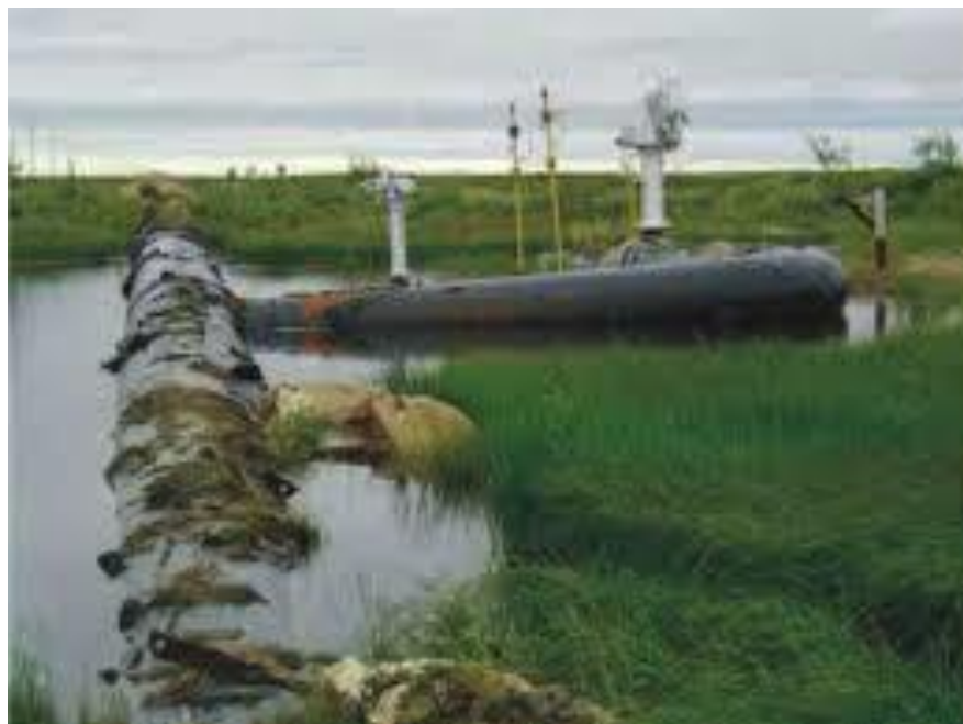
Рисунок 12 – Трубопровод в зоне влияния бугра пучения [15]
