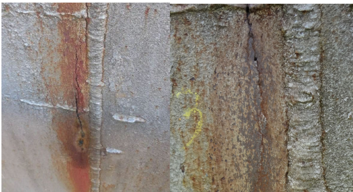
Рисунок 2.1 – Сквозные трещины на стенке резервуара
