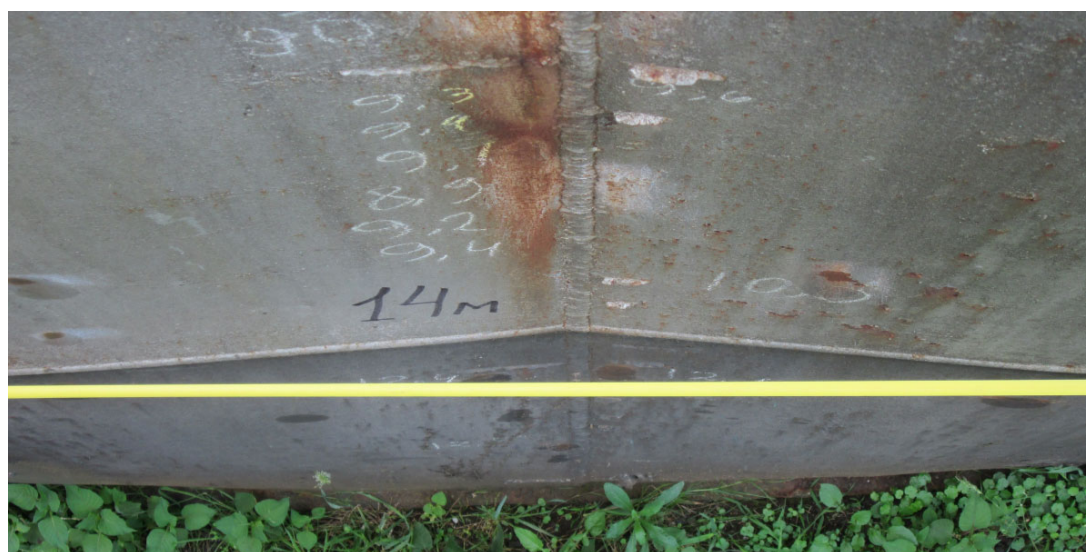
Рисунок 2.2 – Пример сварного шва с угловой деформацией
