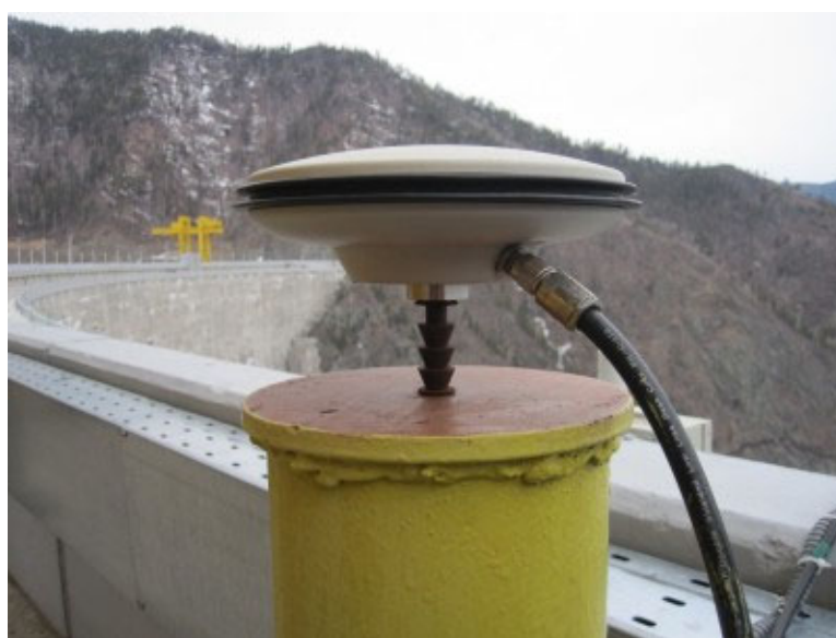
Рисунок 1.17 – Спутниковая антенна, установленная на плотине ГЭС
