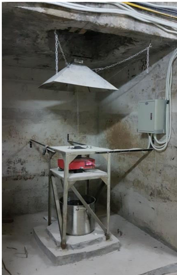
Рисунок 1.6 – Общий вид автоматизированного прямого отвеса в галерее бетонной плотины гидроузла
