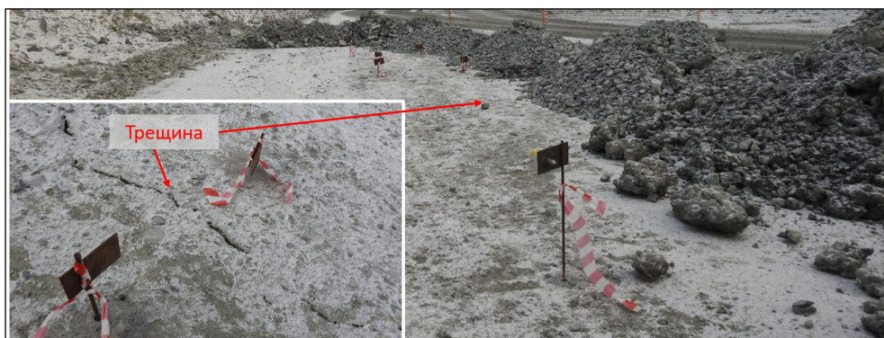
Рисунок 52 – Трещина в дорожном полотне капитального съезда
